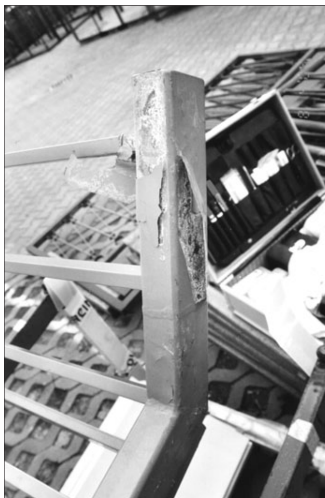
Ein Schadensfall im Blickpunkt: Untervernetzter Pulverlack auf dickwandigen Geländern, der großflächig abplatzt. Bei der untervernetzten Beschichtung wird die Bildung von Weißrost forciert.
