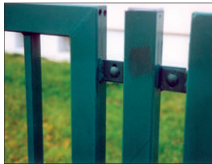
Pulverlackausbesserungen an Zaananlagen mit anders alterndem Nasslacksystem nach drei Jahren Witterungsbeanspruchung.
