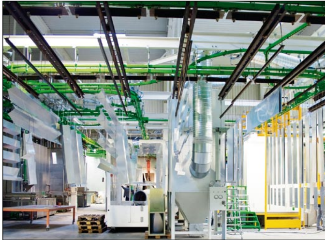
In der neuen Lackieranlage von LOV können Großteile bis 3 m Breite und Höhe beschichtet werden. Das Bild zeigt die Einlaufseite der beiden Automatik-Pulverkabinen. Quelle: LOV
