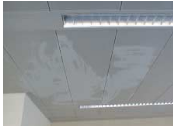
Durch ungeeignete Reinigungsmittel kann der Pulverlackfilm verletzt werden
